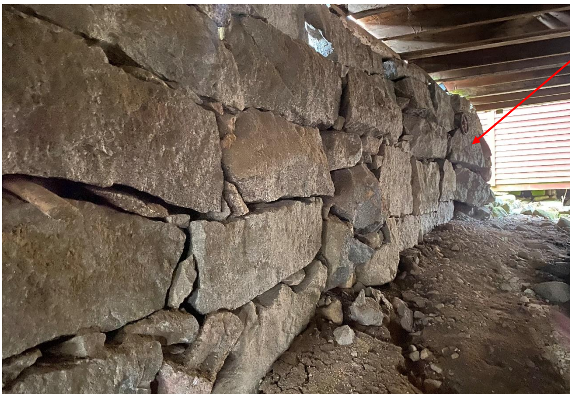
Vid den borte delen av muren syns hur stenarna har kalvat ur läge på grund av påtryckande mark från slänten söder om byggnaderna.
