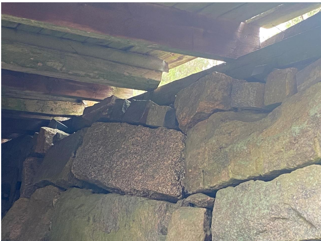
Då muren har kalvat har bjälklaget mist sitt stöd mot syllen, då delarna har sjunkit med i kalvningen.
